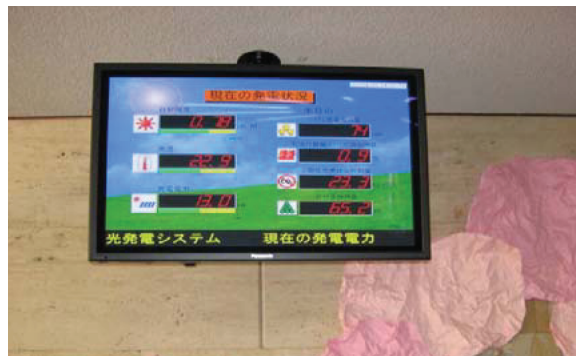
(f) 発電状況のリアルタイム表示装置 (小学校の正面玄関に設置)
